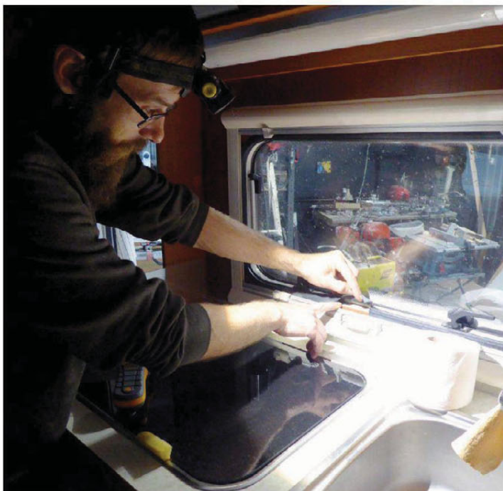
SÅRBART: Patric Mitterbauer løfter på skjøten til en vinduslist, der det kan trenge inn vann.
