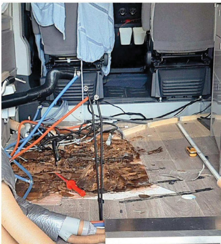
MORKENT GULV: Bybobilen var bare noen år gammel, men her har vann rent ned fra gjennomføringen til takventilen. Under varmepannen var gulvet råttent.
