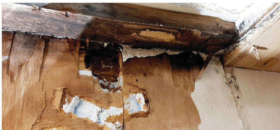
PILL RÅTTENT: Slik kan det se ut når vann trenger inn gjennom noen skruer hull i en taklist. Dette resulterte i stor skade der bærende trebjelker hadde råtnet.
