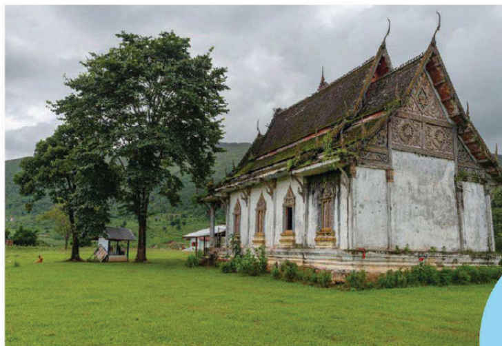
TEMPELET: Tempelet Vang fikk bygget i Long Tieng. Taket lekker, bygningen henger knapt sammen, men er fortsatt i bruk.
